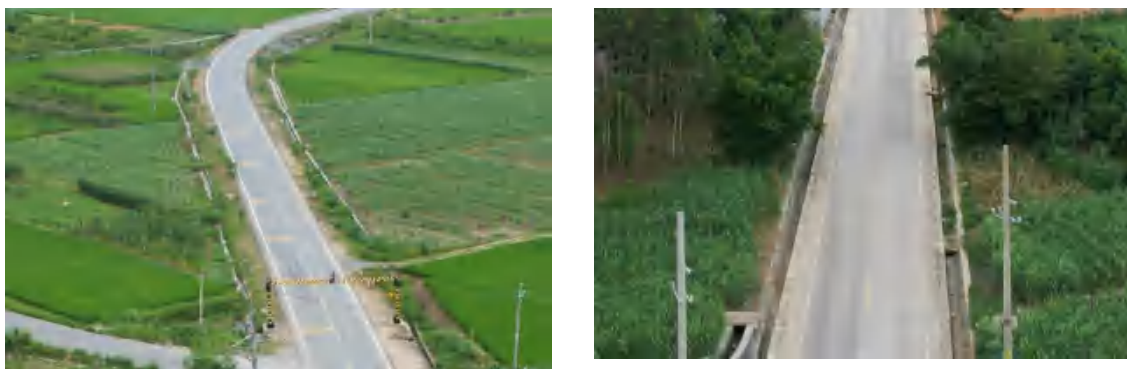
图 4.2-2 典型排水设施现状
