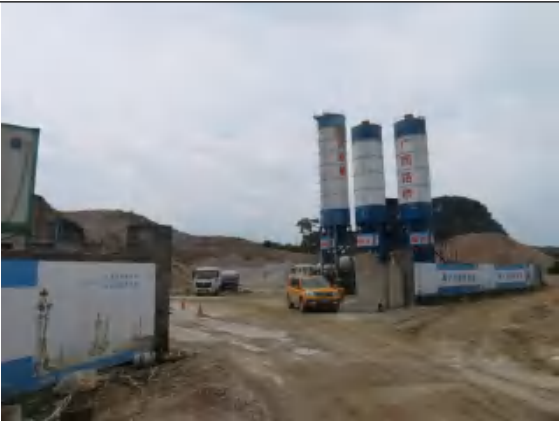
粉料仓筒及仓顶除尘器
